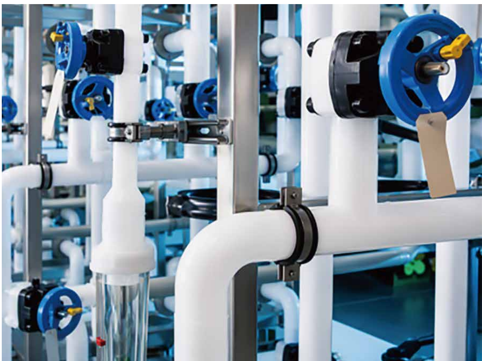
超純水・薬液輸送パイプ
